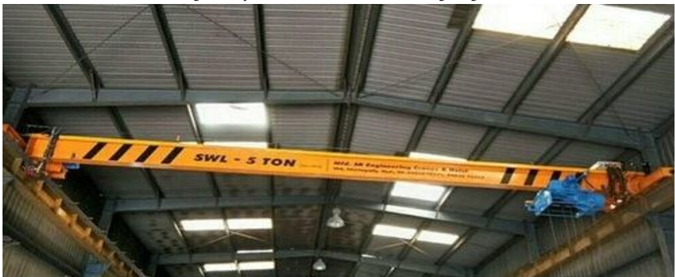
Fig. 3 5 Ton EOT Crane
