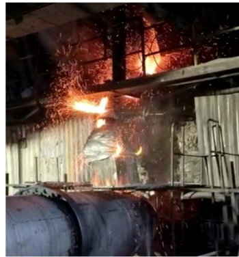
Fig. 4. Slag Leakage in Inlet Pipe
